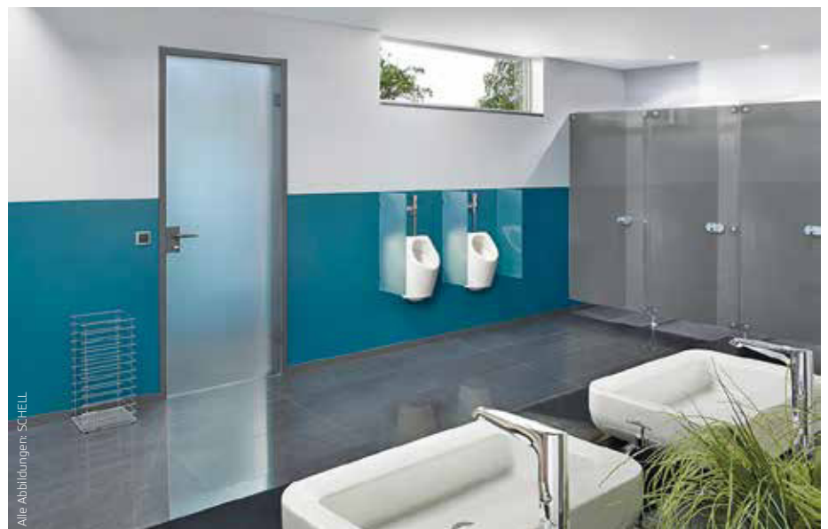
Abbildung 1: Ob zum Händewaschen oder für WC- und Urinalspülung – Trinkwasser wird in nahezu allen öffentlichen, halböffentlichen und gewerblichen Sanitäranlagen benötigt.
