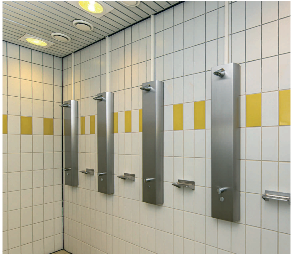
Die Edelstahl-Duschpaneele „Linus Inox DP-C-T“ von Schell sorgen im Westbad Ulm durch die Touch-Bedienung mit selbstschließender Funktion für einen hohen Hygienekomfort. Zudem ermöglichen sie automatische Stagnationsspülungen und tragen so auch zum Erhalt der Trinkwassergüte bei.
