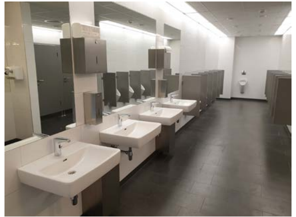
▲ Bild 4 • Im VIP-Bereich wurden 12 XERIS E-Armaturen verbaut. Die Stagnationsspülungen lassen sich bequem über die verbundenen SSC Bluetooth-Module via App einstellen.
