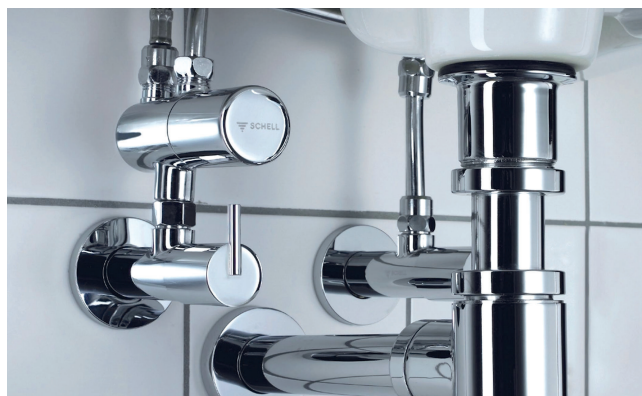
Bild 5: Sind an Eckventilen oder in Waschtisch-Armaturen Thermostate zum Schutz der Nutzer installiert, so muss die Probenahme und die Ermittlung der Systemtemperatur im Rahmen von Legionellenuntersuchungen unbedingt vor den thermostatischen Einrichtungen erfolgen. Bild: Schell
